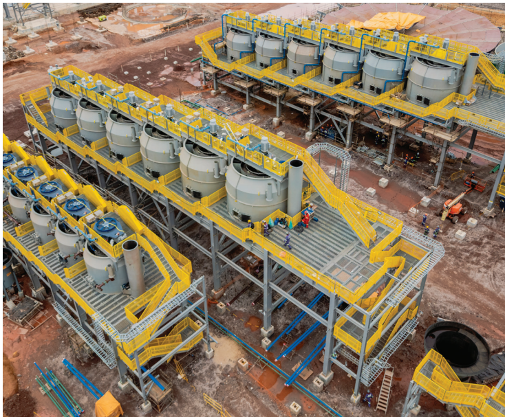
Foto: Planta de processamento do Projeto Tucumã – Pará, Brasil
